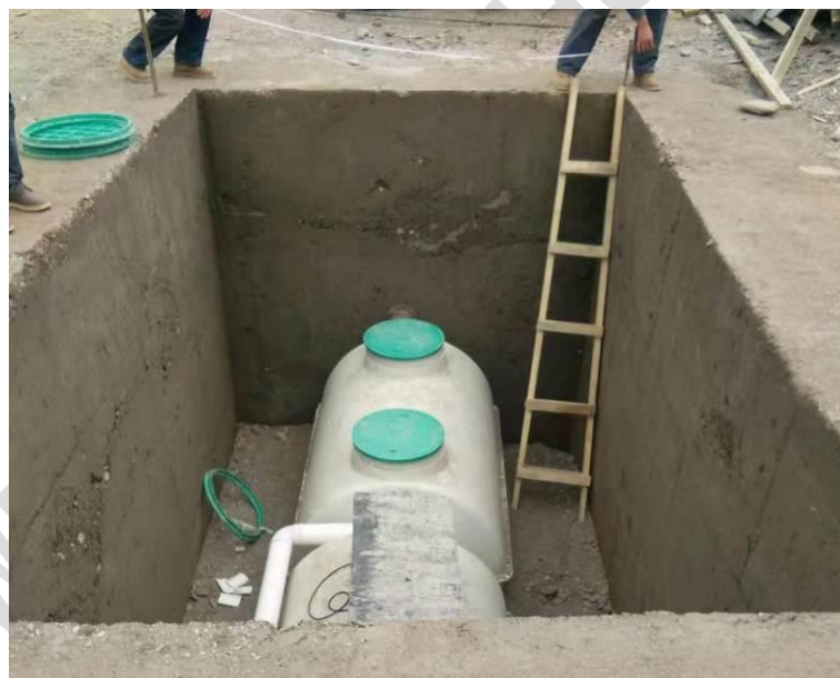
图 7.2-1 业主营地污水处理系统
